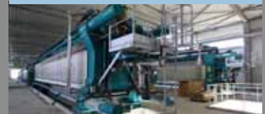
5. ONTWATERINGSINSTALLATIE MET FILTERPERSEN
